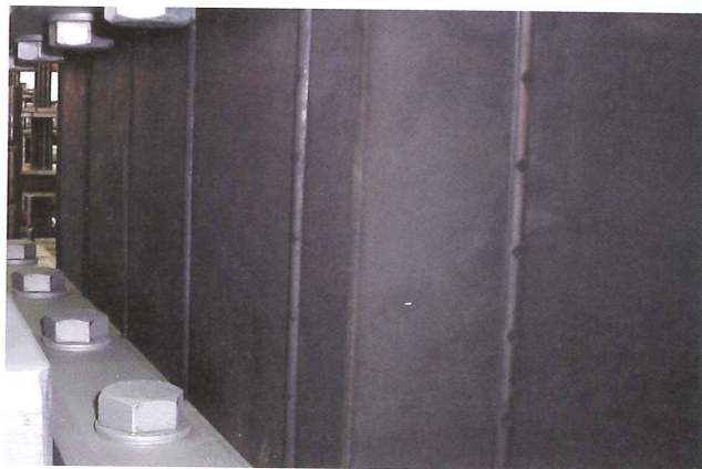
写真3-2. ベントホール痕
