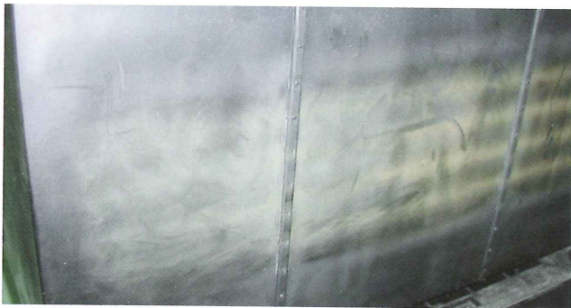
写真4-9. 性能検査後の老化防止剤の滲出
