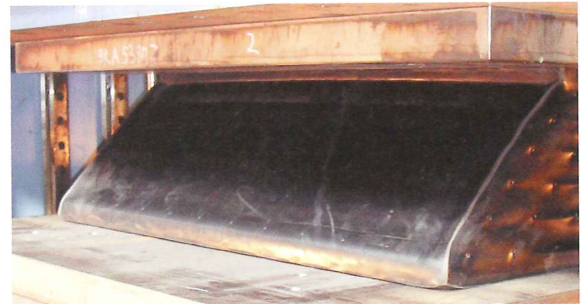
写真4-1. せん断変形時の支承端部のまくれあがり
