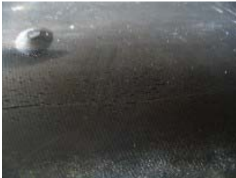
D面に認められた異常個所の接写-2
