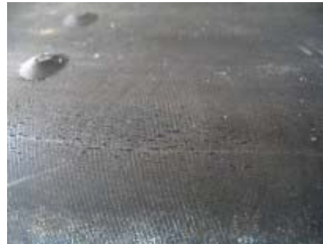
D面に認められた異常個所の接写-3
